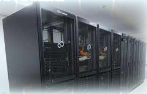
住民記録システムサーバー
