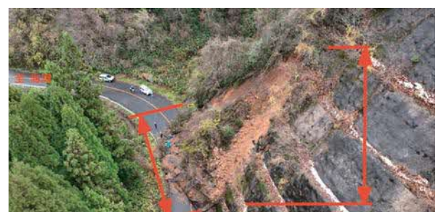
大仁農道の災害箇所
