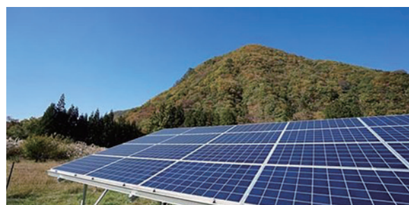
太陽光パネル
