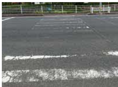
消えかかった横断歩道
