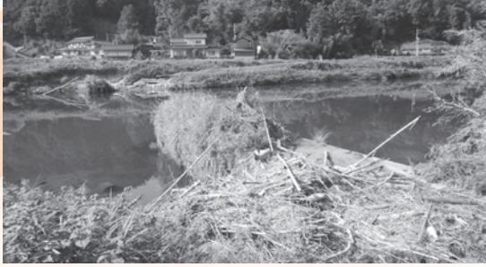
昨年の豪雨により流出した市道里熊小原線の橋
