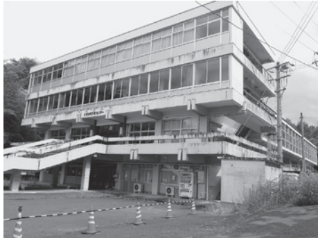
耐震補強が不可能な大東体育文化センター
