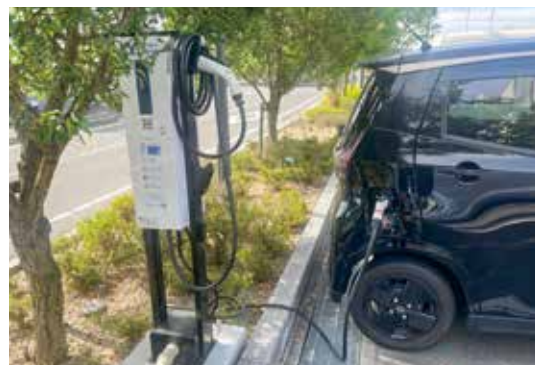
EV充電設備
