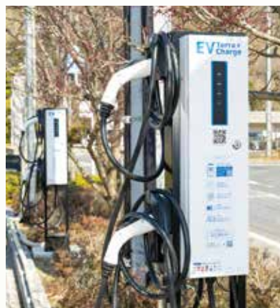
▲電気自動車用充電設備（雲南市役所）
