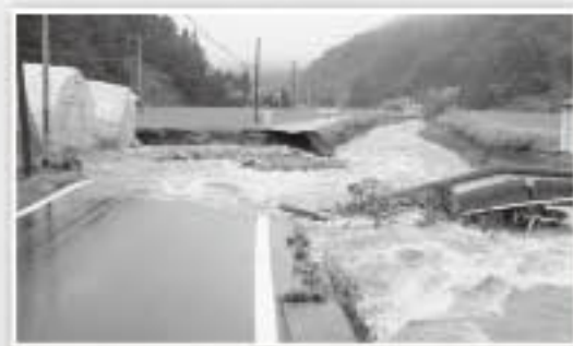
平成18年7月の大雨による被害の様子
