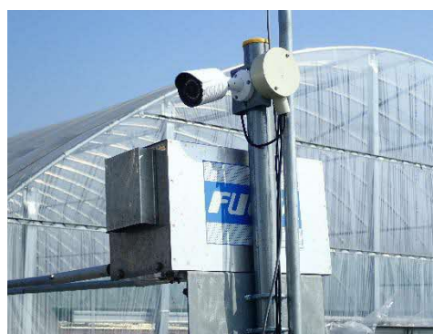
防犯カメラの設置
