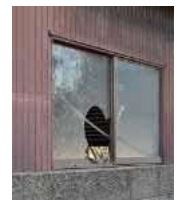
窓が割れた 管理不全空家
