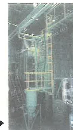
RDF燃焼設備 ▶
