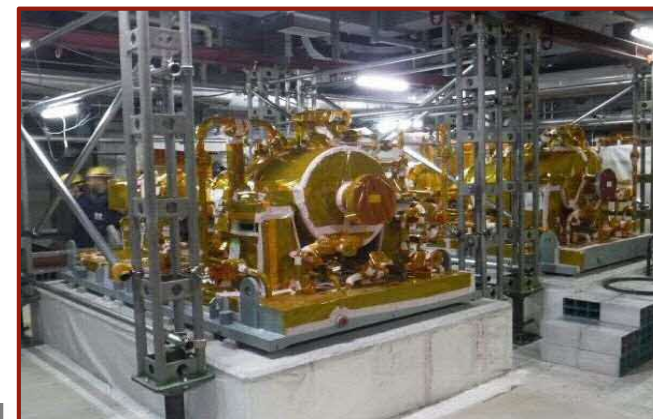
▲残留熱代替除去ポンプ
