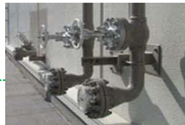
▲ 送水車接続口等を設置し、対応を迅速化
