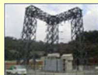
第二66kV 開閉所
