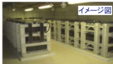
▲ 緊急時に用いる蓄電池
