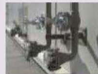
代替注水配管
