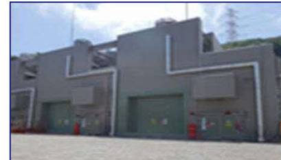
▲ガスタービン発電機
