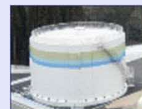
ろ過水タンク (追加・補強)
