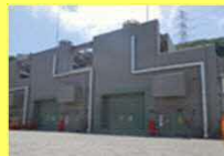
ガスタービン 発電機
