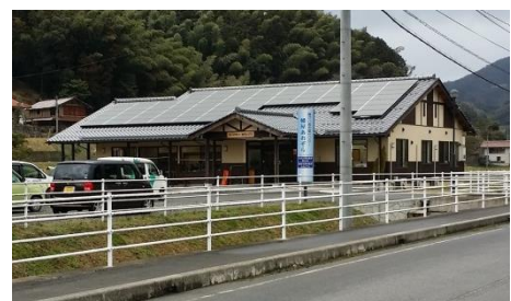
近隣施設の屋根を借りた 太陽光発電パネル
