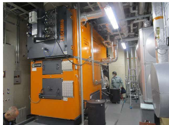
バイオマスチップボイラー
