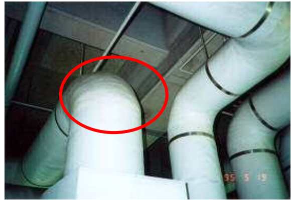
保温材（配管等）
