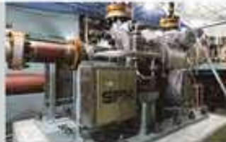
高圧原子炉代替注水ポンプ
