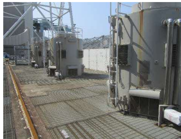
放射線管理区域外にある役目を終えた設備の解体撤去 (循環水ポンプの撤去【今年度実施予定】)
