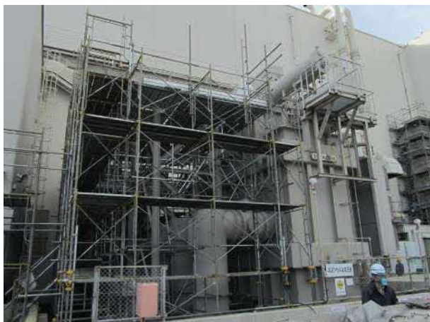
放射線管理区域外にある役目を終えた設備の解体撤去 (主変圧器等の撤去【完了】)
