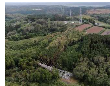
鉄塔設備の倒壊 (君津市)
